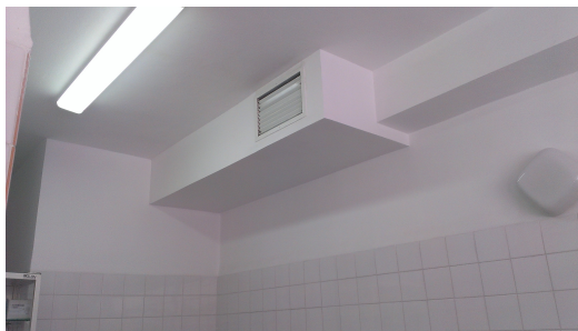
fot 7. Widok istniejącej wentylacji
