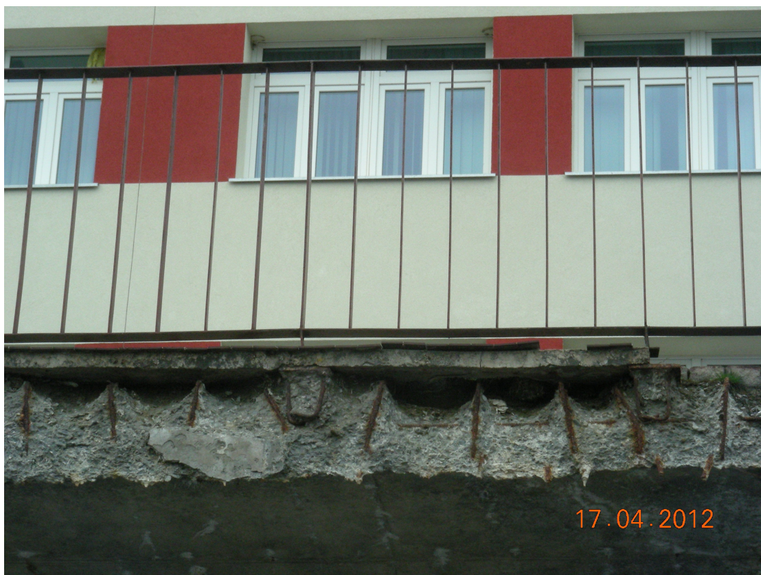
Fot. 6 Ubytki betonu i korozja zbrojenia '2012.
