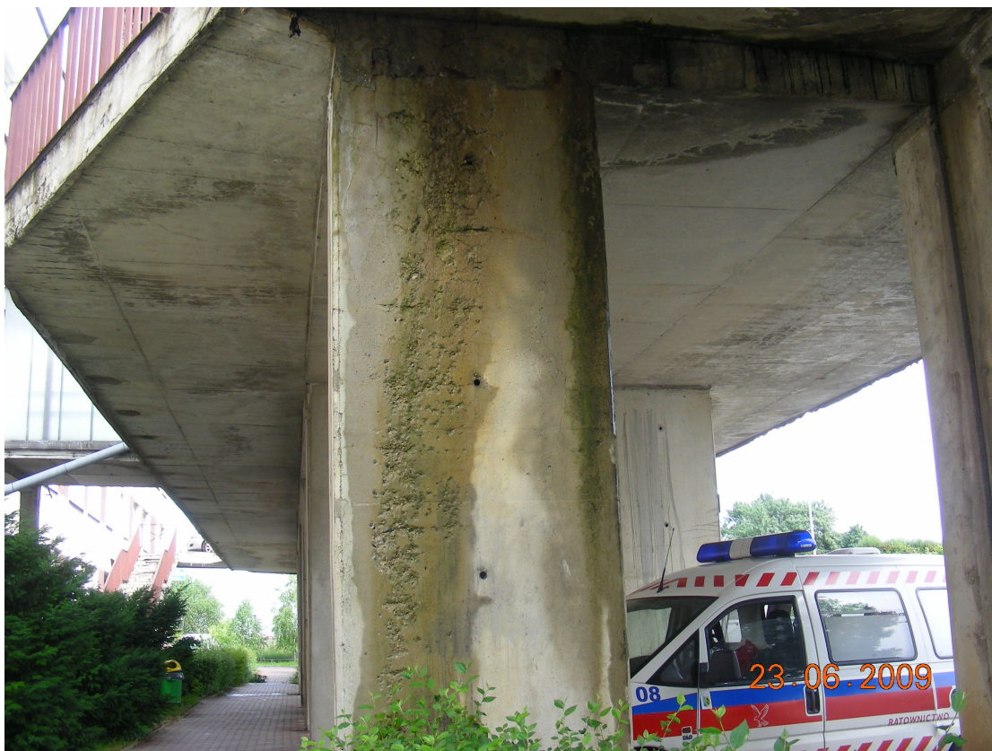
Fot. 19 Zniszczenie słupów od przecieków z dylatacji '2009.
