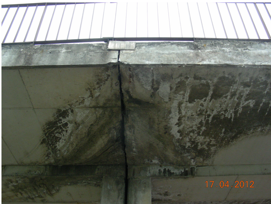
Fot. 10 Zawilgocenia konstrukcji wskutek przecieków dylatacji '2012.
