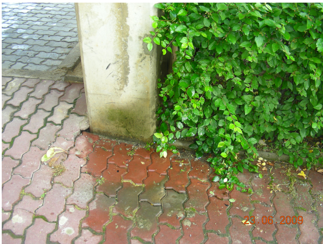
Fot. 23 Osiadanie kostki od przecieków z dylatacji '2009.
