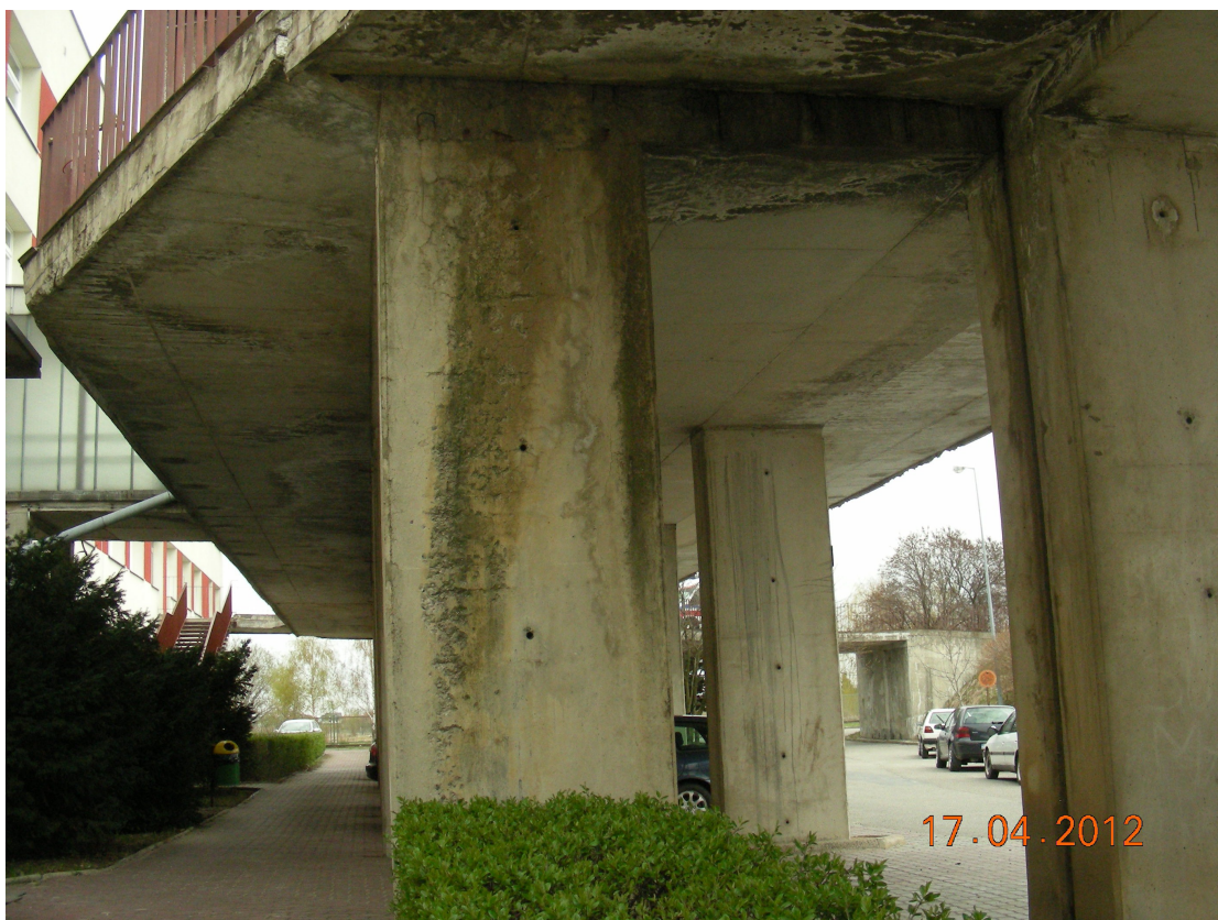
Fot. 20 Zniszczenie słupów od przecieków z dylatacji '2012.
