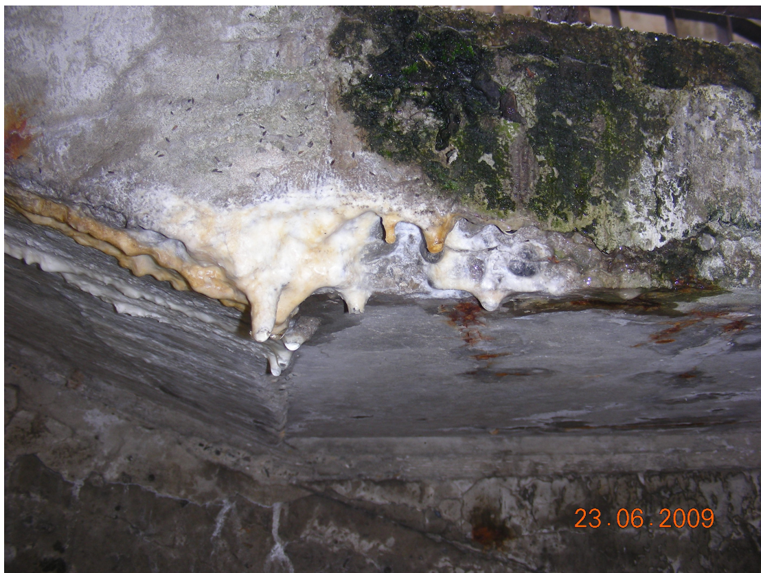
Fot. 11 Zasolenie konstrukcji żelbetowej w postaci „sopli” ‘2009.
