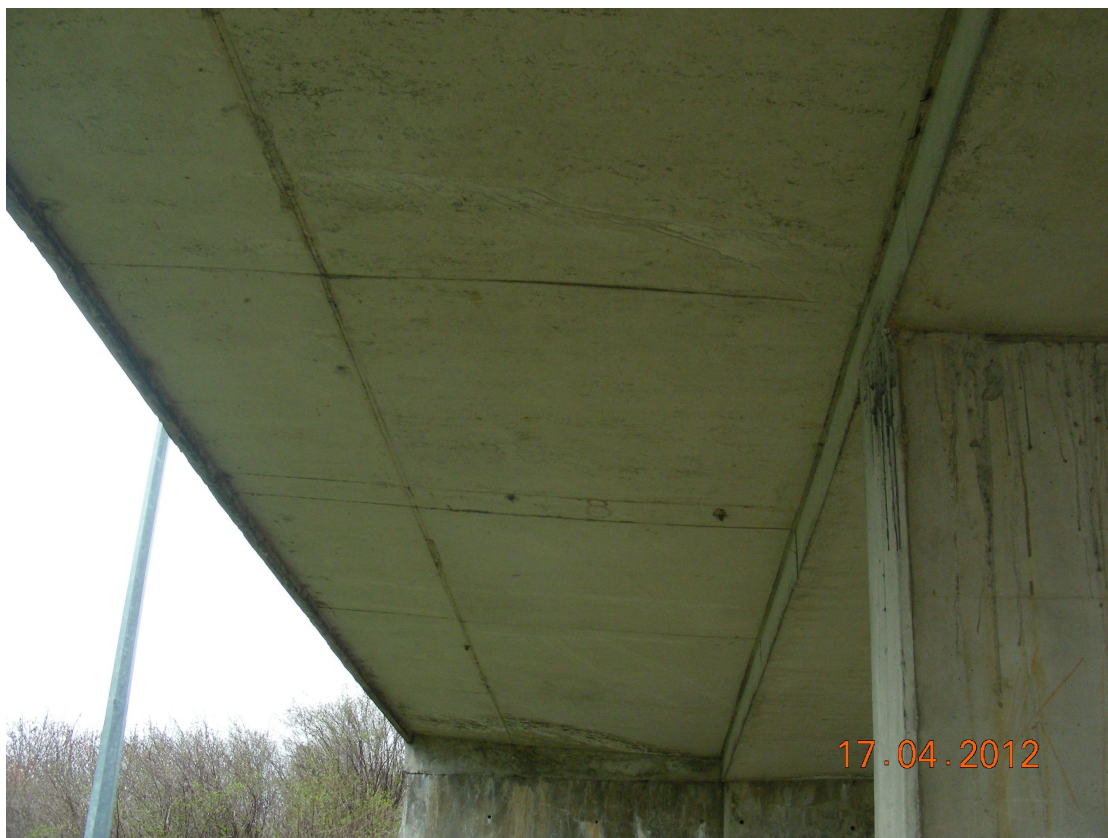
Fot. 8 Spękania i zarysowania betonu konstrukcji '2012.
