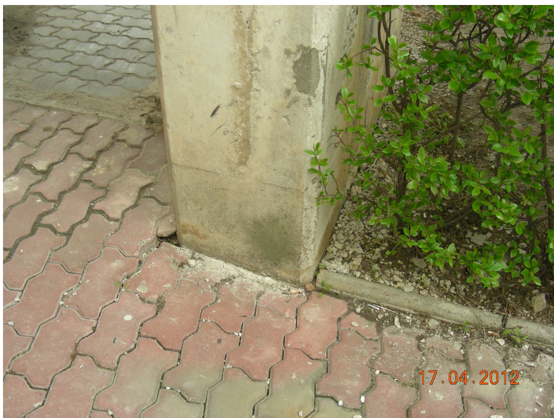
Fot. 24 Osiadanie kostki od przecieków z dylatacji '2012.
