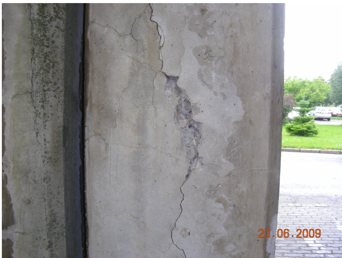
Fot. 13 Spękania słupów przydylatacyjnych '2009.
