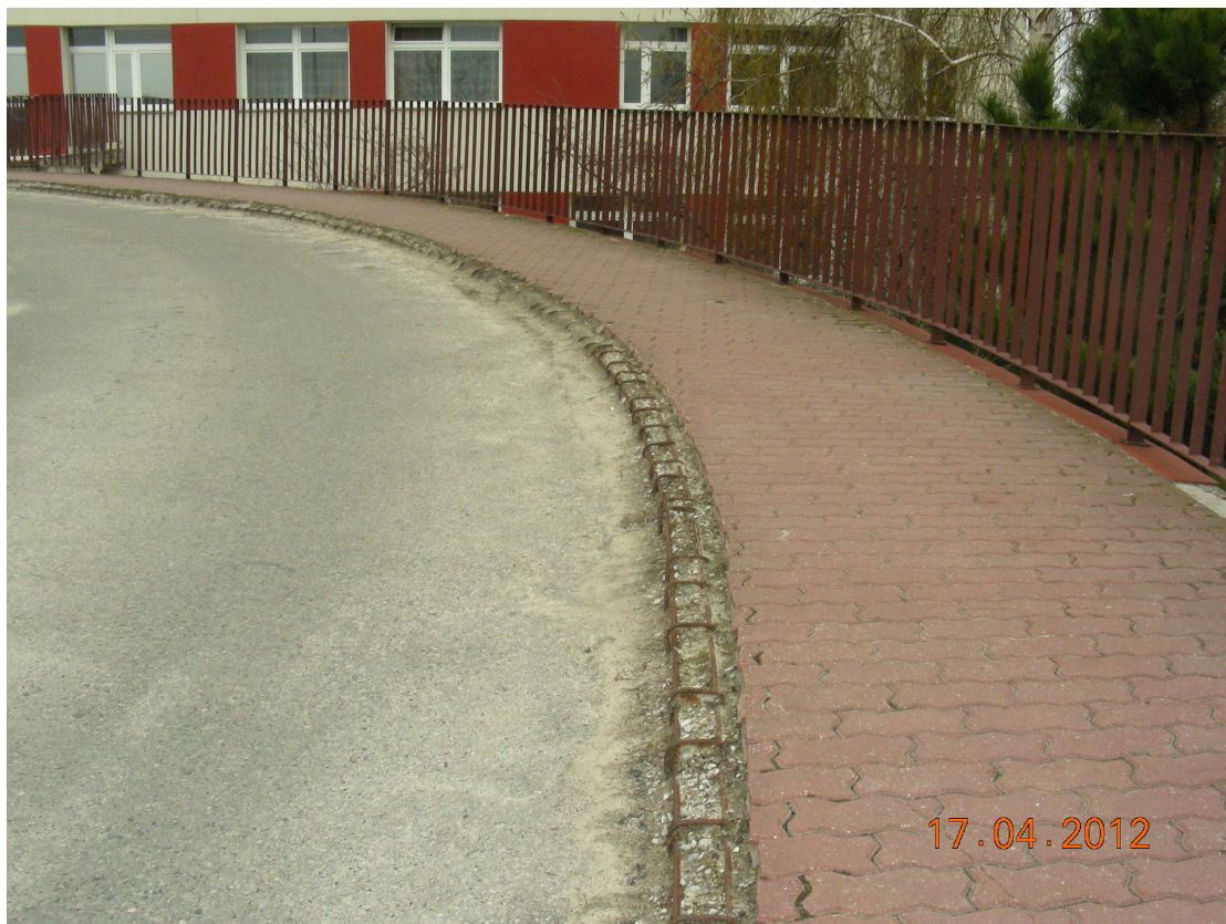
Fot. 16 Całkowite zniszczenie krawężników żelbetowych '2012.
