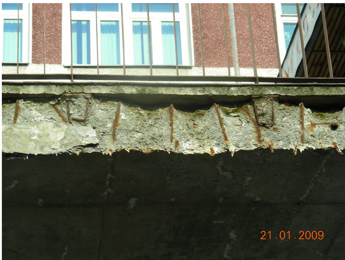
Fot. 5 Ubytki betonu i korozja zbrojenia '2009.
