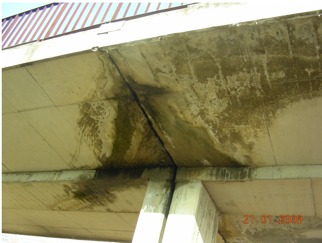
Fot. 9 Zawilgocenia konstrukcji wskutek przecieków dylatacji '2009.
