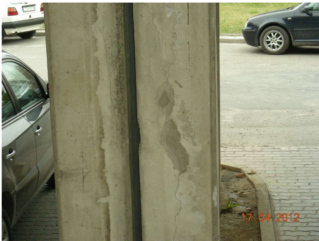
Fot. 14 Spękania słupów przydylatacyjnych '2012.
