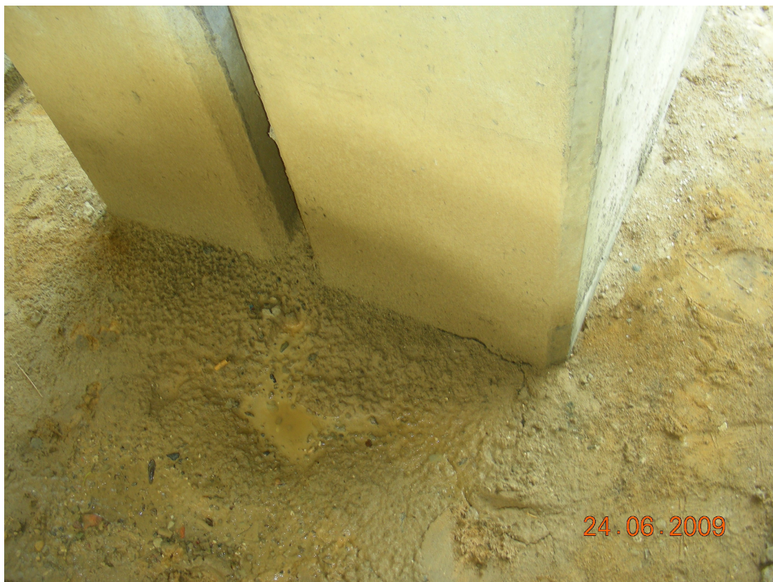
Fot. 21 Zamoczenie gruntu od przecieków z dylatacji '2009.
