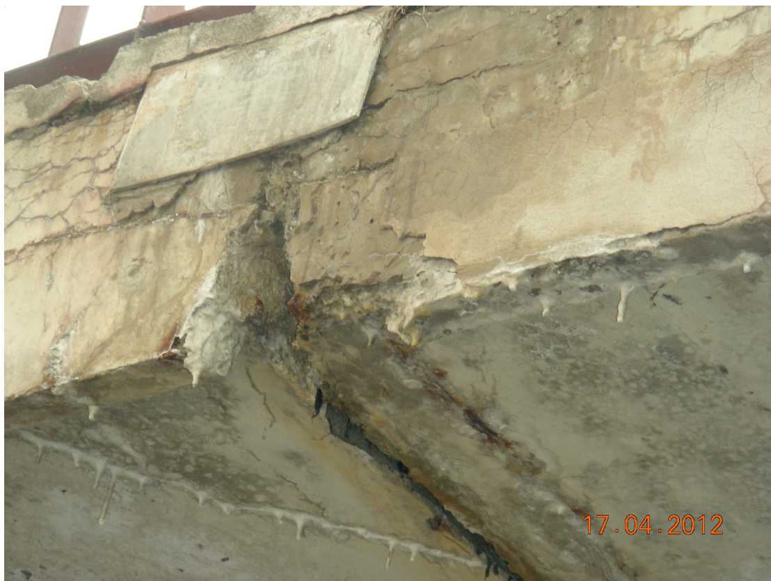
Fot. 12 Zasolenie konstrukcji żelbetowej w postaci „sopli” ‘2012.
