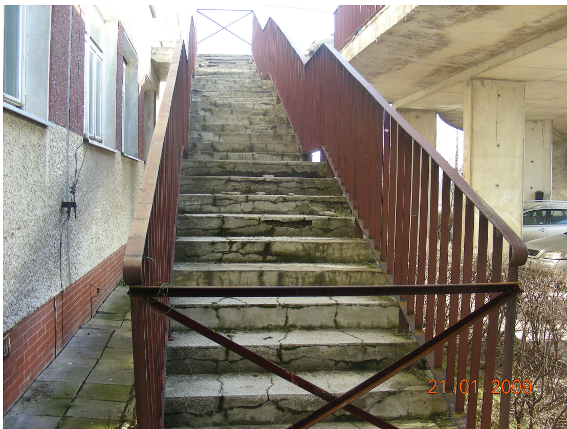
Fot. 17 Całkowicie zniszczone schody '2009.
