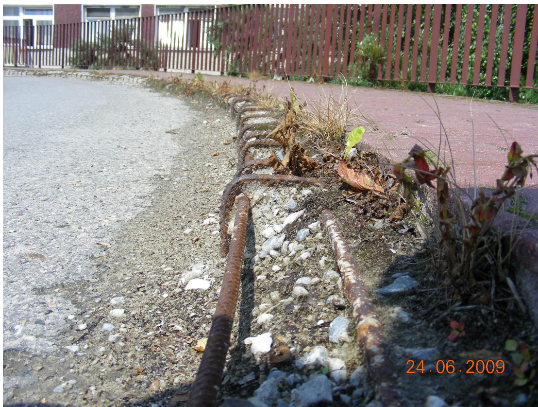
Fot. 15 Całkowite zniszczenie krawężników żelbetowych '2009.
