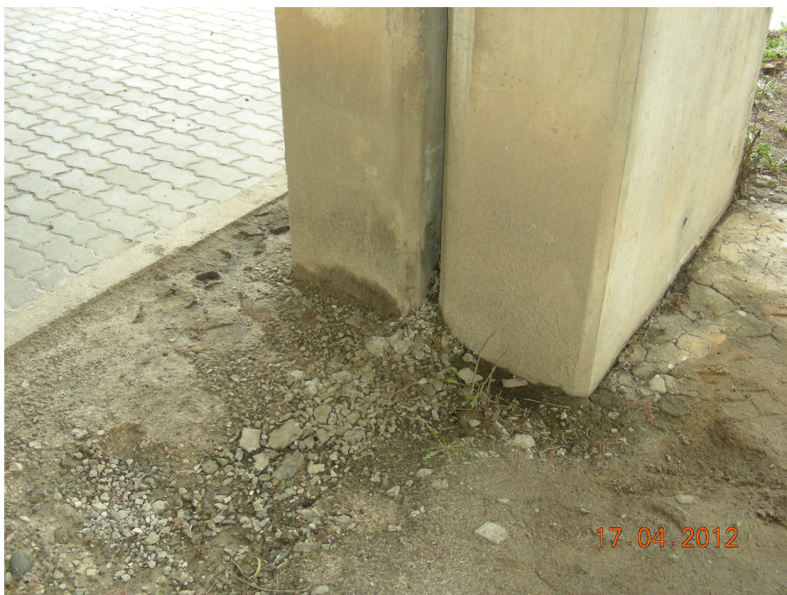
Fot. 22 Zamoczenie gruntu od przecieków z dylatacji '2012.
