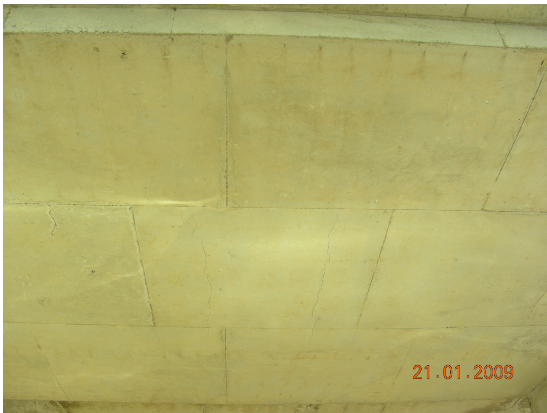
Fot. 7 Spękania i zarysowania betonu konstrukcji '2009.
